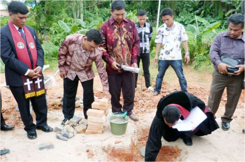
PELETAKAN BATU PERTAMA GBKP TABJUNG PINANG, 12 MEI 2013 Tampak dari kiri ke kanan: Pt. Robinson Ketaren (Ketua Bajem Tanjung Pinang), Pt. Arnol Reymond Ginting (Ketua BPMR Bida Ayu), Pt. Dirgahayu Tarigan (Ketua BPMR Batu Aji), Juska Purba (Permata - belakang), Alex Chandra Tarigan (Mamre-belakang), Pdt. Sahat Tarigan (Ketua BPMK Riau Sumbar-meletakkan batu pertama), Pt. Lesta Tarigan (Bendahara BPMK Riau Sumbar).
